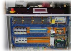
Schaltschrank HBP 530 A
